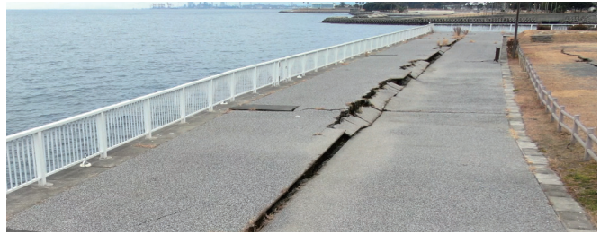
高崎山駐車場の被害
