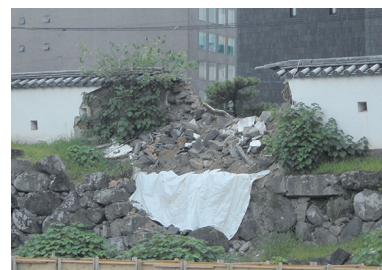
崩落した城壁
